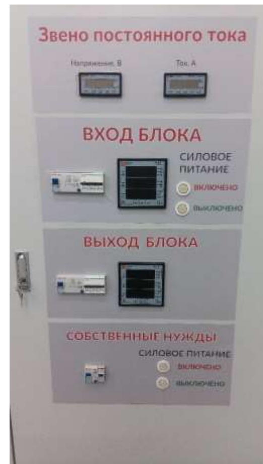
Дверь с приборами и выключателями
