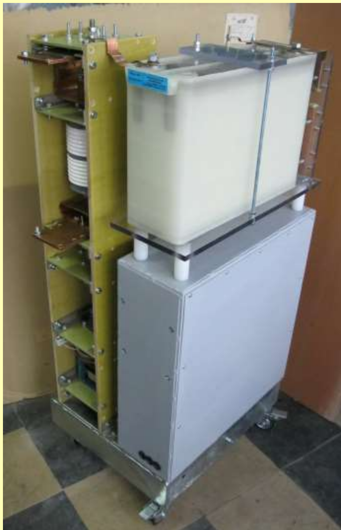
Выключатель постоянного тока
